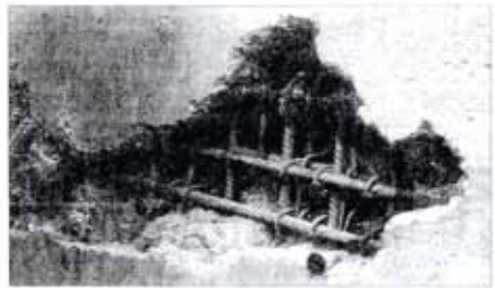
Photo d'un mur de la piscine du bâtiment où sera entreposé le combustible irradié de Flamanville. Ce cliché, comme beaucoup d'autres, a été pris en avril, après le décoffrage du béton. La ferraille à l'air, les encenites du futur réacteur sont pleines de trous béants...
