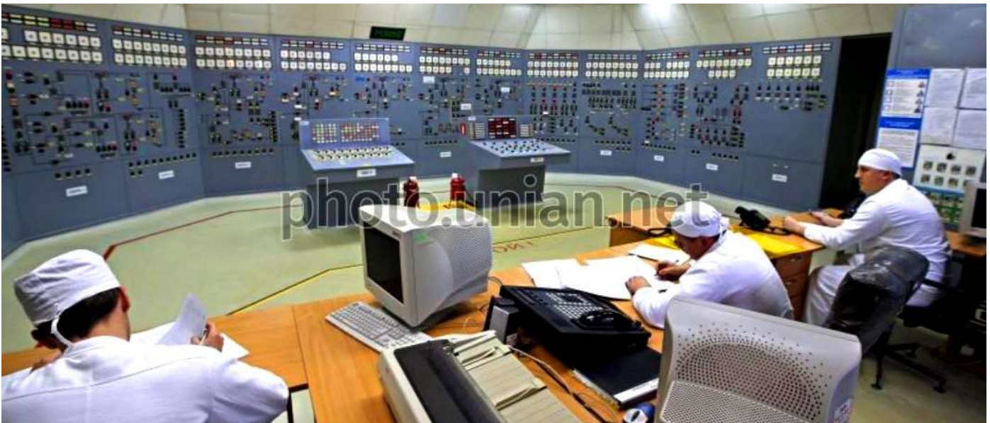
Salle de contrôle-commande de Zaporijia.
